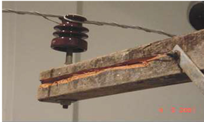
Figura 1 - Dano causado em cruzeta por surto impulsivo de tensão
