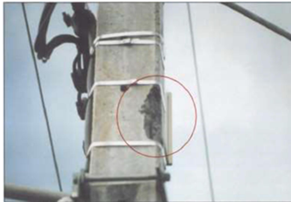
Figura 4 - Dano causado no poste por descarga disruptiva [7]
