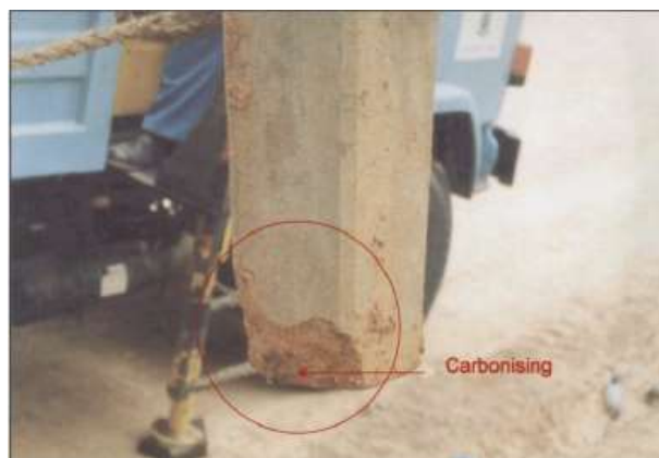
Figura 5 - Dano na parte enterrada do poste por descarga atmosférica [7]
