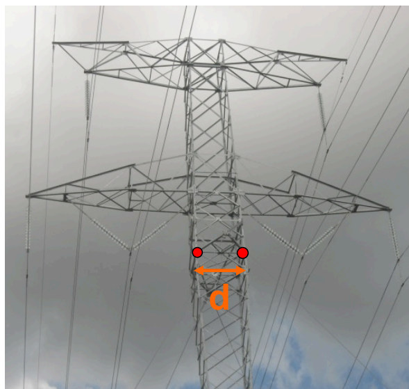
FIGURA 8 – Posição de instalação dos cabos underbuilt nas torres estaiadas da LT.
