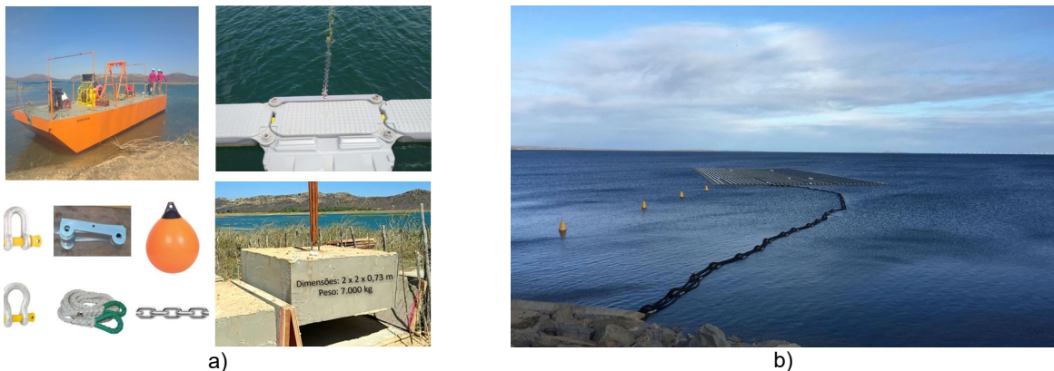
FIGURA 10 – a) Principais componentes do sistema de ancoragem adotado no projeto. b) Plataforma fotovoltaica flutuante de 1 MW montada e ancorada no reservatório da UHE Sobradinho. – Fonte G1 Bahia. Foto: Felipe Pereira/TV São Francisco
