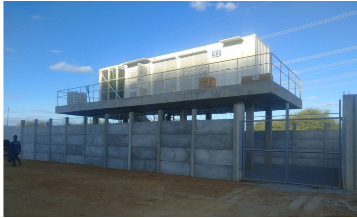
FIGURA 4 – Eletrocentro instalado sobre sua base ainda em fase de construção.
