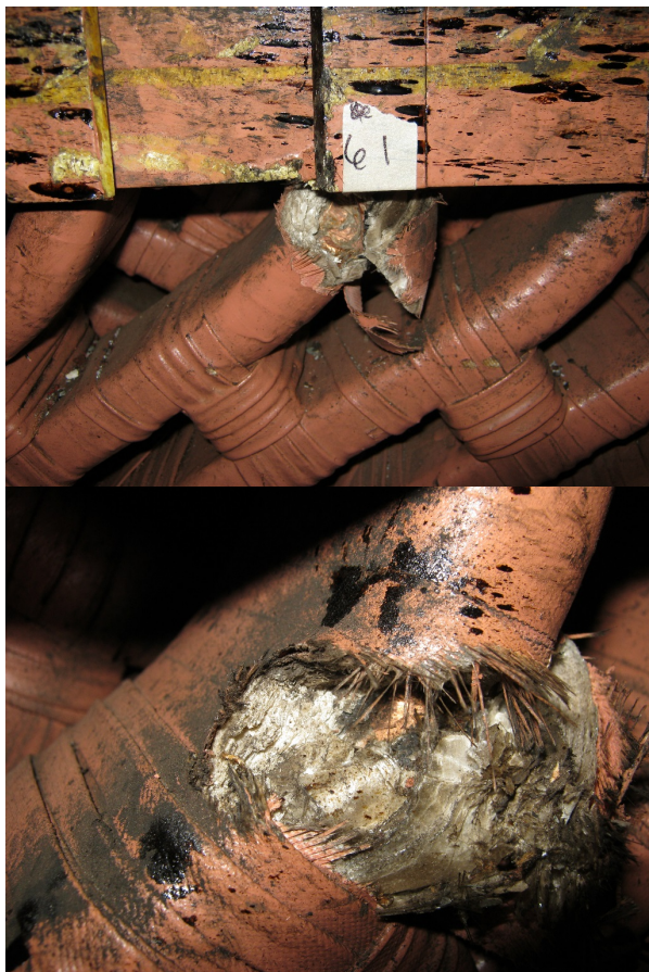
Figura 3 – Barras do estator: Inspeção visual e danos nos Condutores
