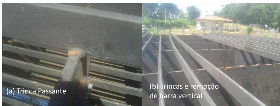
FIGURA 1 – (a) Trinca passante entre as barras verticais frontais e a bandeja do painel da grade; (b) Falha causada por trincas, com posterior remoção das barras verticais. Fonte: Lactec, 2015.
