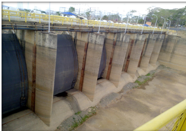
FIGURA 2 – Nível crítico do reservatório. Vertedouro todo exposto.
