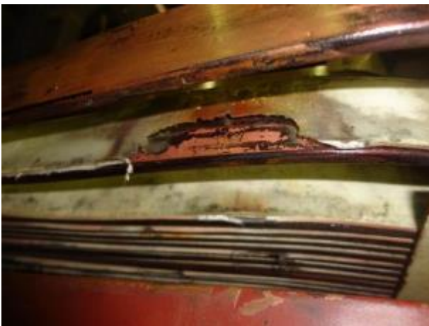
FIGURA 15 – Isolação entre espira danificada no curto
