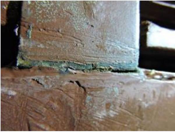
FIGURA 5 – Conexão entre os polos trincada
