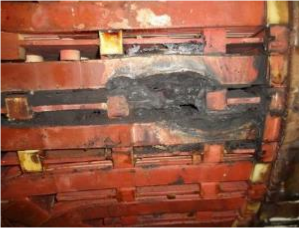
FIGURA 11 – Detalhe da região do curto circuito
