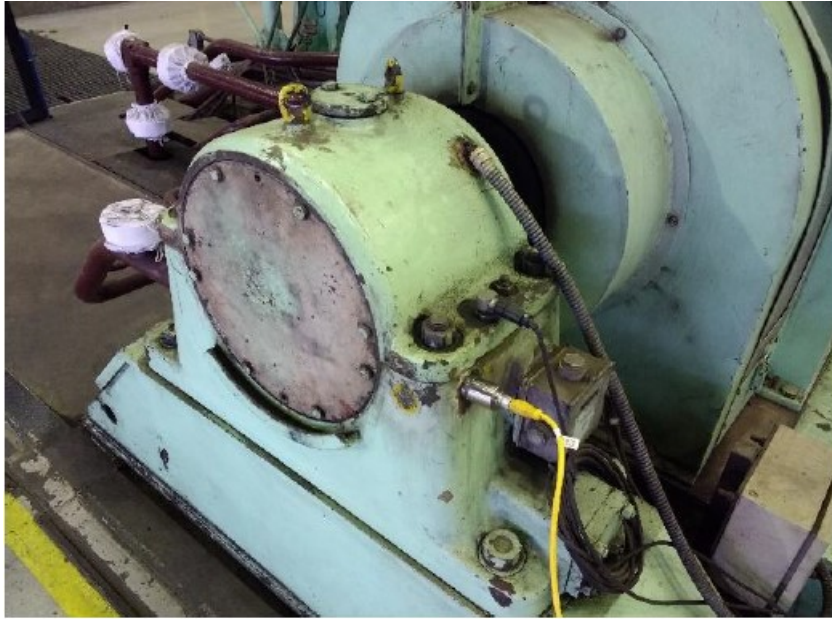
FIGURA 10 – PAD e sensor triaxial efetuando medição preditiva em mancal de gerador de uma usina térmica a carvão de 365 MW.
