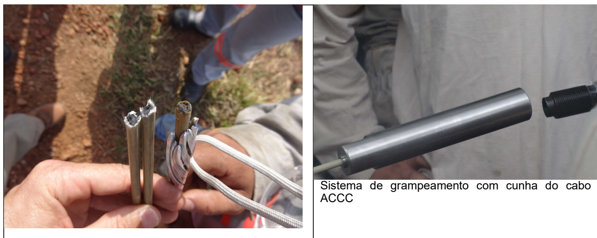
FIGURA 3 – Detalhes e algumas particularidade de instalação do cabo ACCC
