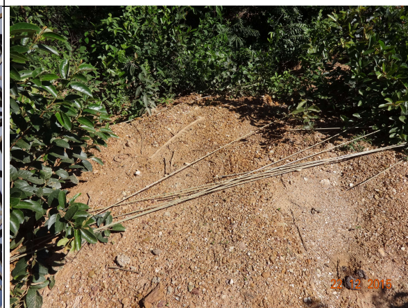
Alma de compósito após o furto de cabos
