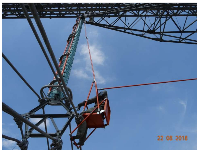
FIGURA 2 – Material de linha viva instalado na cadeia de isoladores
