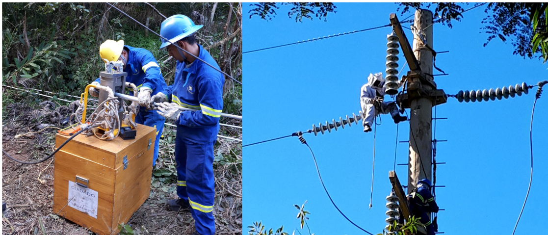
FIGURA 8 – (a) Compressão dos terminais dos cabos / (b) Abelhas no topo do poste
