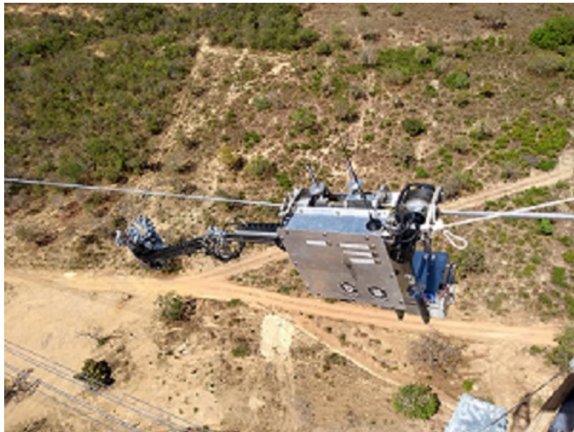
FIGURA 6 – Segundo teste realizado em linha desenergizada (XRTE – 800kv)
