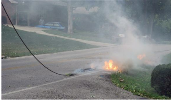
FIGURA 1 – Conductor rompido energizado em contato com asfalto, caracterizando uma FAI.
