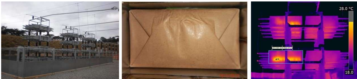
FIGURA 4 - CEMIG - Banco de Capacitores – Fusível Interno, 230kV, 60,48Mvar
