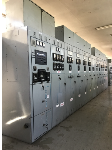
FIGURA 3 – Setor 13,8 kV existente.
