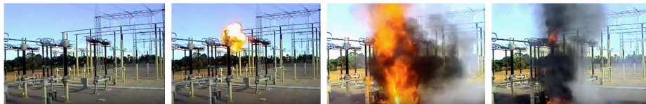
Fig. 11 – Sequência mostrando explosão de um TC em uma subestação.
