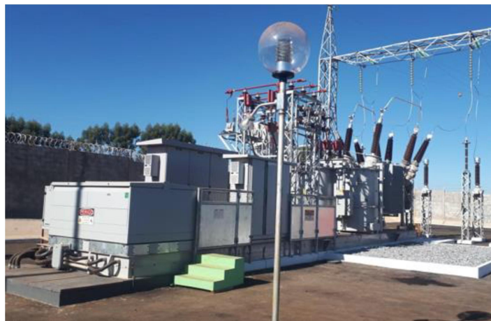
Fotografia 2 – Visão da subestação com a SECI.
