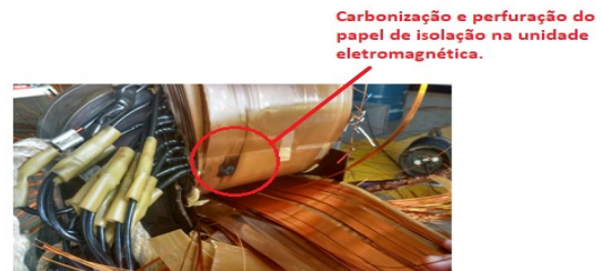
Figura 14 – Carbonização encontrada após dissecação da unidade eletromagnética de um TPC de 230 kV
