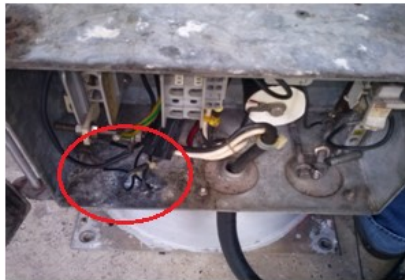
Figura 13 – Sinais de centelha e descarga na caixa de HF do TPC de 230 kV
