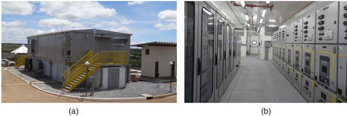
FIGURA 3 – a: vista externa do MIMC – MT da SE Confinis; b: vista interna do MIMC-MT painéis do SAS à esquerda e conjunto de manobra à direita (Fonte: CEMIG)
