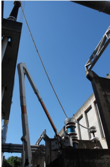
Figura 3 – Conexão da fonte ressonante (Hypotronics) e do divisor capacitivo na SIG
