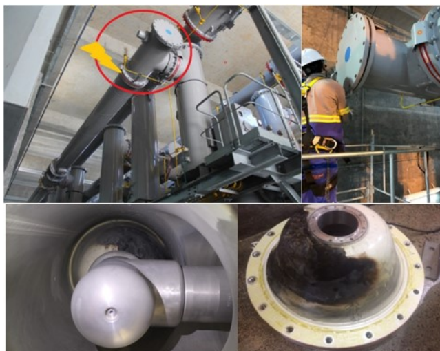
Figura 7 – Compartimento com o isolador stop-gas falhado
