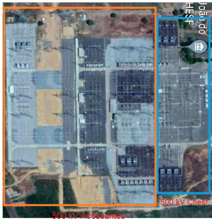
FIGURA 4 – Subestação São João do Piauí – 500 kV
