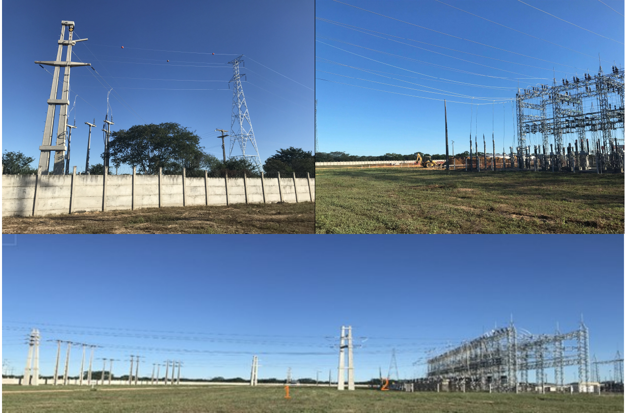
FIGURA 1 – Entrada em cabo subterrâneo isolado (1) e aérea (2) EL 69 kV ENEL - SE Bom Jesus da Lapa
