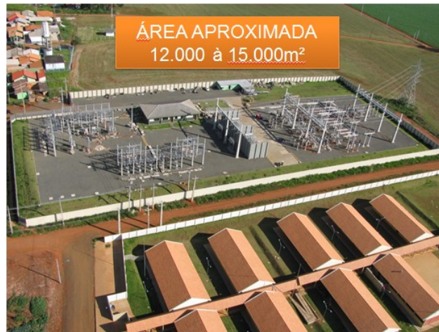
Figura 01: Subestação Copel Arapoti 138kV
