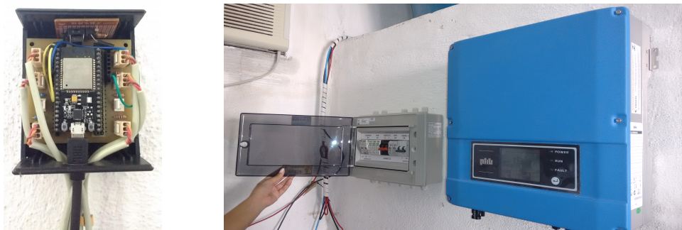
Figura 3 – Módulo IoT ESP 32, string box e inversor da planta FV de Fortaleza
