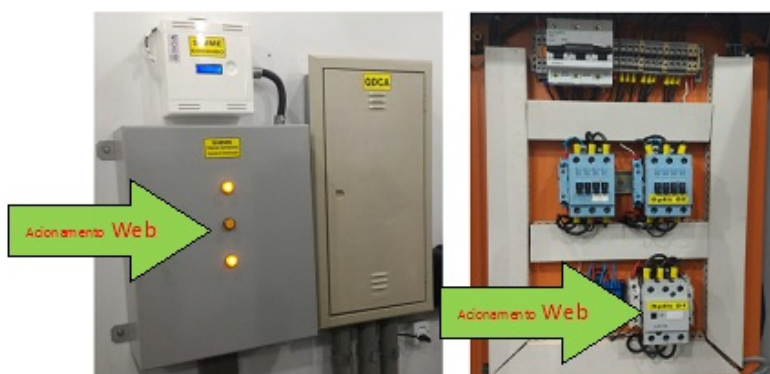
Fig. 6 – Quadro de Comando montado em campo.
