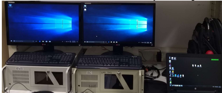
FIGURA 4 – Testbed com arquitetura simplificada baseada em equipamentos Siemens e terceiros
