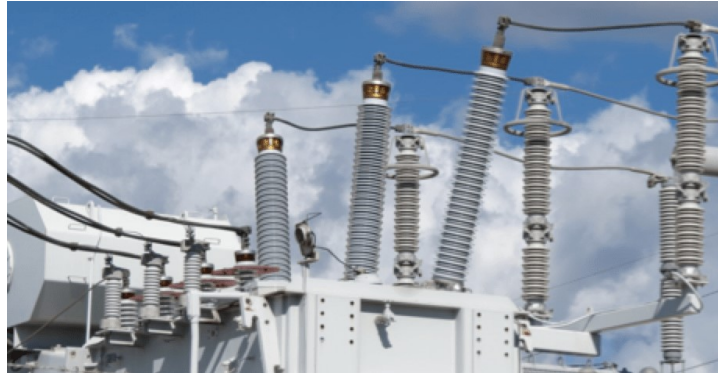
Figura 1 – Para-raios de porcelana posicionado na parte superior do transformador (Fonte: INMR, 2019)
